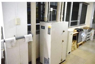
お湯を頻繁に使っていたので給湯器が設置されています
